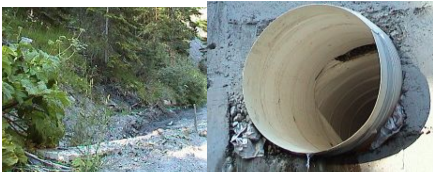
Şekil 5. Büzün menba kısmından bir görünüş, büzün yırtığı ile görünüşü
