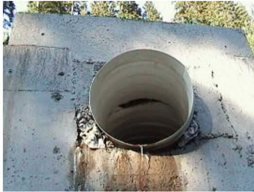
Şekil 2. Malzemeleri doğru kullanılmamış dejenere olmuş PVC boru büz
