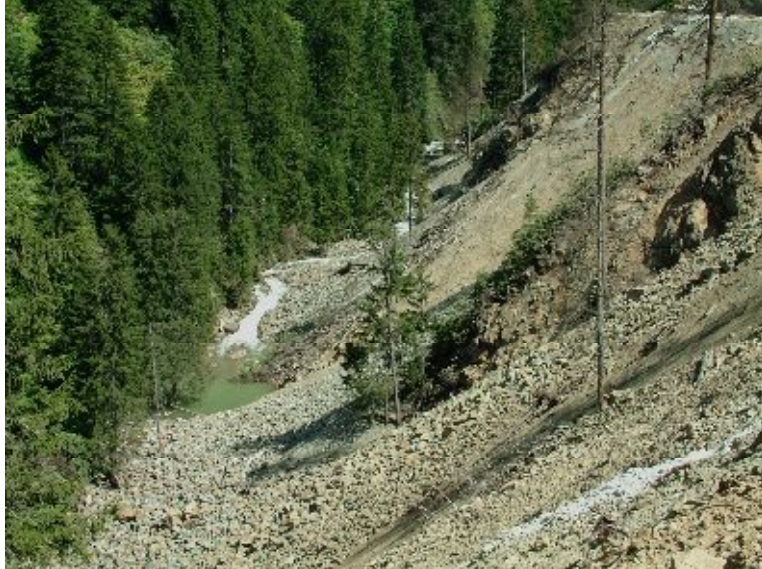
Şekil 1. Murgul Kabaca Vadisinde yapılmakta olan bir HES için yapılan yol inşaatının oluşturduğu tahribat
